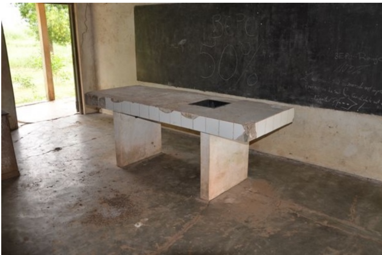
Les locaux de l'école sont encore très peu équipés et en mauvais état (Photo EclAt).
